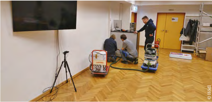
Installationsarbeiten durch den Haus- und Transportdienst, das Technische Serviceteam und die IT
